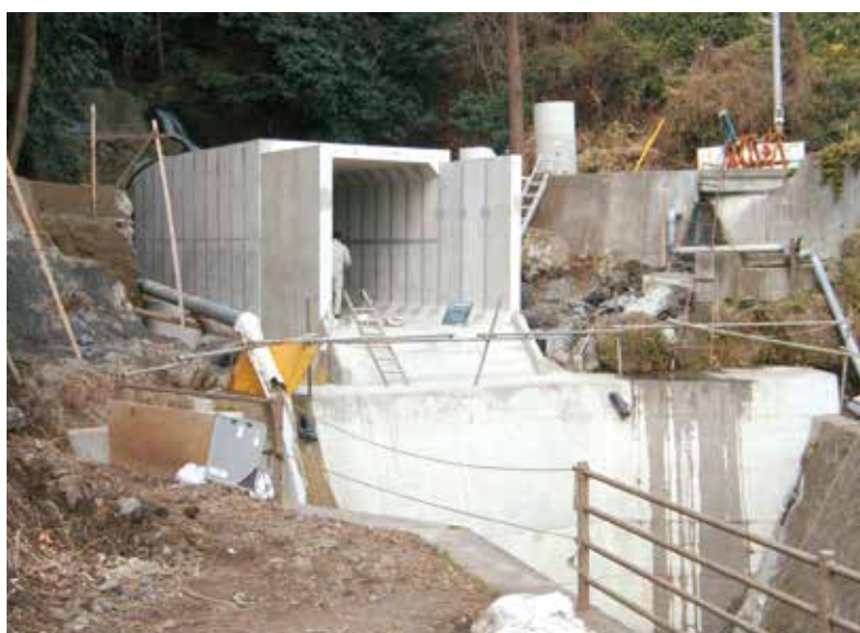
ボックスカルバート水路
