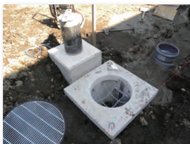
洗浄ユニット貯水槽と井戸
