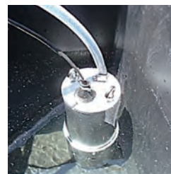
給水ポンプを貯水槽・井戸等に設置
